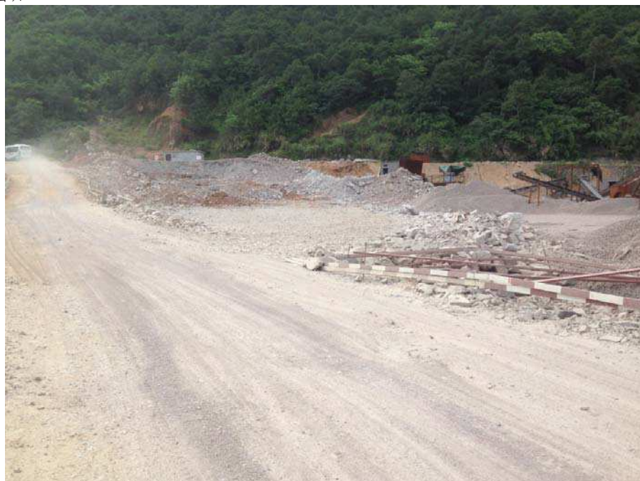
图 3-1 隧道出口轧石厂及临时堆石场地
