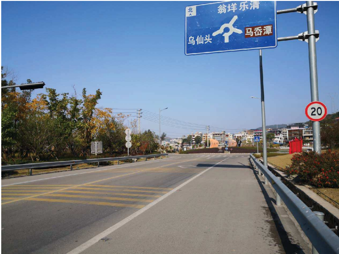
图 1-7 隧道出口段路面现状
