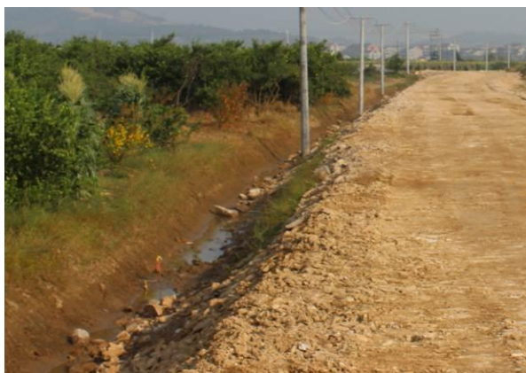
土质临时排水沟
